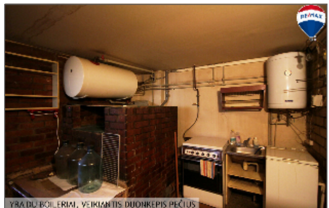
YRA DU BOILERIAI, VEIKIANTIS DUONKEPIS PEČIUS
